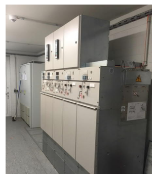
20 kV Schaltanlage Station 1
